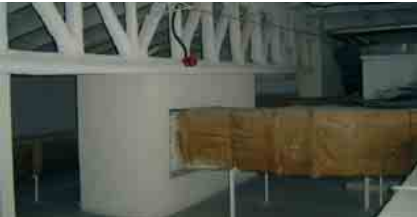
Amianto proyectado en una cercha.
