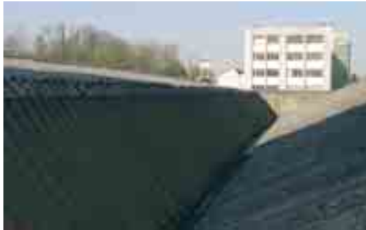
Fibro cemento. Amianto no friable.
