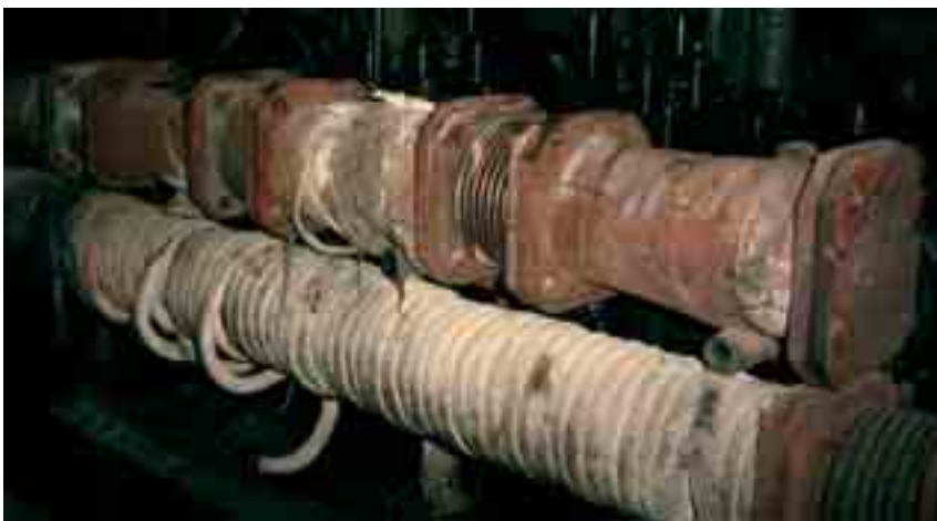
Calorifugado en forma de cordón.
